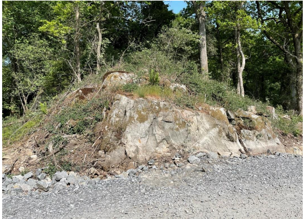
Figur 13. Berget vid arbetsväg i den västra delen av Norra området är framsprängt i samband med byggnation av transformatorstation.
